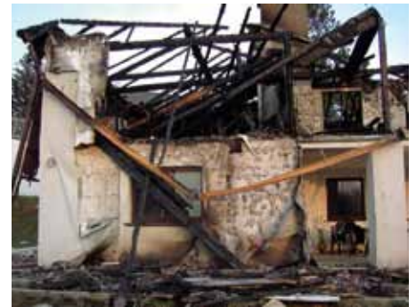
Völlig zerstörtes Wohnhaus in Gablitz.
